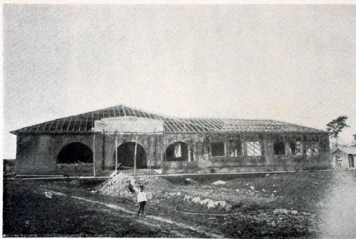
Grupo Escolar da Capital — estado do prédio em 1946, cinco anos depois de iniciado... Como se vê, os edifícios envelheciam ainda no esqueleto, sem servir ao seu destino, por falta de continuidade administrativa.
